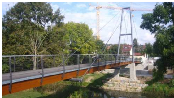
Bild 3: Der Gussasphaltbelag dient als schützendes Dach für den darunterliegenden Träger aus Brettschichtholz. Um die direkte Bewitterung an den Seiten gänzlich auszuschließen, wurden diese mit einer Holzverschalung versehen.
