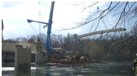
Bild 4: Montage eines Teilstücks einer Hohlkastenbrücke, das vorher im Werk weitestgehend vorgefertigt und per Schwerlastkraftwagen zum Zielort gebracht wurde.
