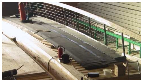
Bild 3: Die Fertigung im Werk: Unten die blockverleimten Träger, dann folgen als Feuchtesperre sich überlappende Bitumschweißbahnen. Um den konstruktiven Holzschutz zu vervollständigen, wird über die Bitumschweißbahn eine Blechabdeckung angebracht. Zum Schluss folgt der Gussasphaltbelag.
