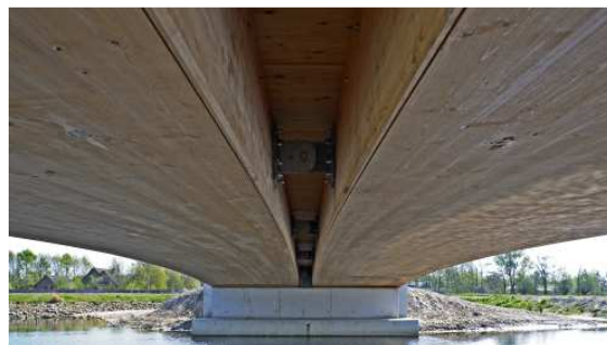
Bild 2: Ansicht auf die Unterseite und auf die beiden aus BSH blockverleimten Trägern.
