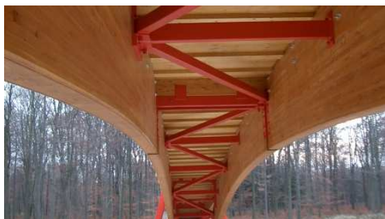
Bild 3: Ansicht auf die Unterseite. Als Queraussteifung kommt rot lackierter Stahl zum Einsatz.
