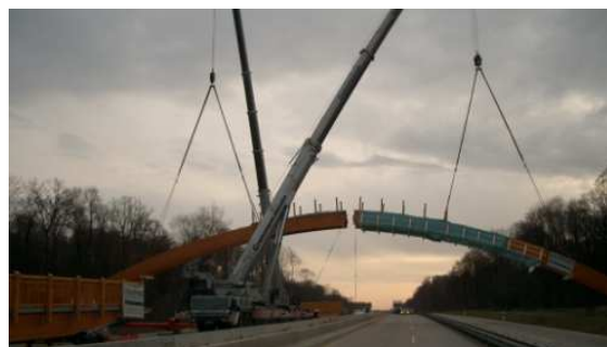
Bild 4: Die Montage des Bogens erfolgte mit 2 Schwerlastkränen und unter kurzer Vollsperrung der A4 am frühen Abend.
