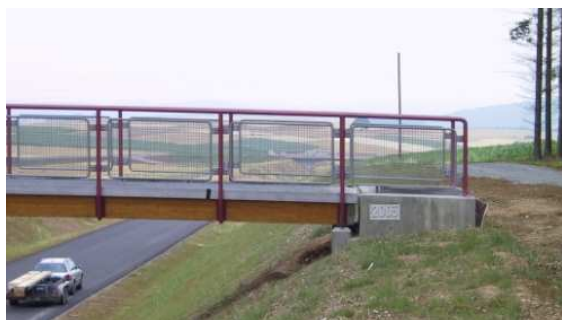
Bild 3: Ansicht auf das Widerlager: Schutz der Hirnholzenden durch ausreichenden überstehenden Fahrbahnbelag und Blechabdeckung.
