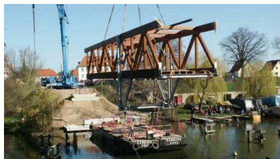
Bild 4: Die Montage des zusammengesetzten Tragwerkes erfolgte in zwei Schritte. Hier wird der erste Teil platziert. Dabei wurde auch ein schwimmender Ponton eingesetzt.
