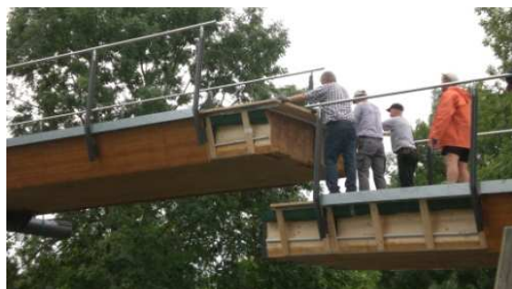
Bild 3: Montage des zweiten Teilstückes der Brücke. Die seitliche Holzverschalung aus 3-Schichtplatten, die den konstruktiven Holzschutz gewährleistet, ist gut zu erkennen.
