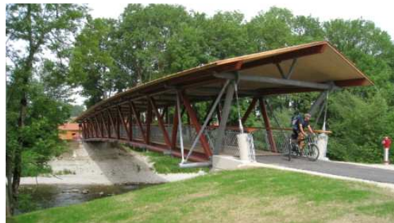
Bild 2: Das Dach aus Kupferblech bietet dem Tragwerk optimalen Schutz gegenüber der Witterung.
