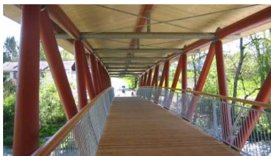
Bild 3: Der Bohlenbelag aus Holz, das Geländer und die BSH-Rundhölzer des Fachwerkes sind gut zu erkennen.
