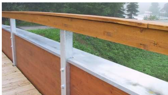
Bild 3: Die Geländerpfosten sind aus Stahl und der Handlauf ist aus Holz. Der offene Bohlenbelag weist eine geriffelte Oberfläche zur Rutsicherheit auf.
