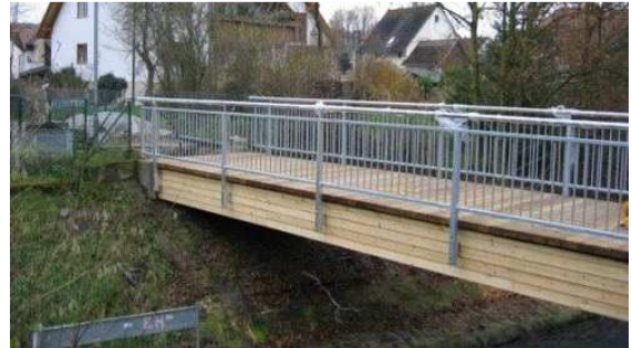
Bild 2: Die seitliche Holzverschalung bietet einen konstruktiven optimalen Holzschutz. Das Geländer ist als Stahlfüllstabgeländer ausgeführt.
