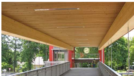
Bild 3: Abgehängene Decke mit integrierten Versorgungsleitungen
