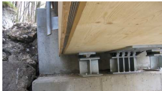
Bild 2: Ansicht auf die Widerlager und auf die hinterlüftete Schalung, die das Haupttragwerk vor der Witterung schützt. Der Blockträger wurde aus blockverleimten BSH hergestellt.
