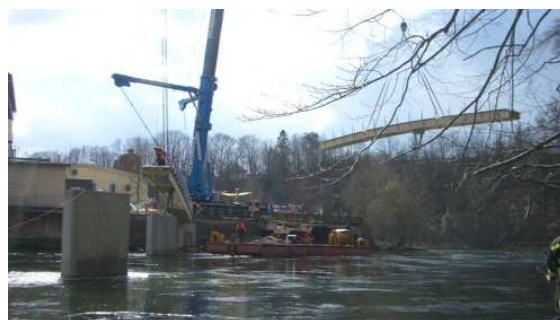
Bild 4: Montage des zweiten Teilstückes. Dieses wird mit Hilfe eines Krans an die richtige Position gesetzt und über Stahlbleche und Passbolzen miteinander verbunden.
