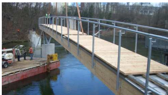
Bild 3: Montage des Anfangsstückes der Brücke, wobei auch ein schwimmender Ponton zum Einsatz kam. Alle Einzelteile wurden im Werk so weit wie möglich vorgefertigt und mit Schwerlasttransportern zum Zielort gebracht.
