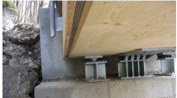
Bild 2: Ansicht auf die Widerlager und auf die hinterlüftete Schalung, die das Haupttragwerk vor der Witterung schützt. Der Blockträger wurde aus blockverleimten BSH hergestellt.
