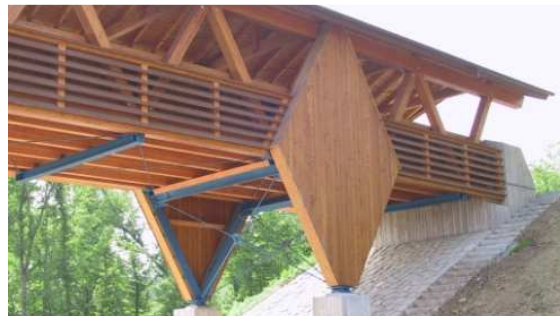
Bild 2: Ansicht auf die schützende Untergurtverkleidung aus Douglasien-Dreischichtlamellen, den Rundstahlverbund der Aussteifung und das verkleidete Zwischenauflager.
