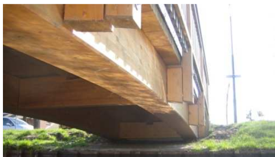
Bild 3: Ansicht auf die Unterseite. Die Queraussteifung wurde bei dieser Deckbrücke ebenfalls aus BSH gefertigt.
