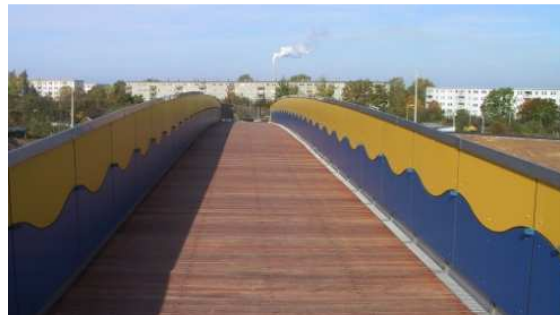
Bild 2: Ansicht auf die Bohlen aus Bongossi. Auf der Innenseite werden die BSH-Träger durch Trespa-Platten geschützt.
