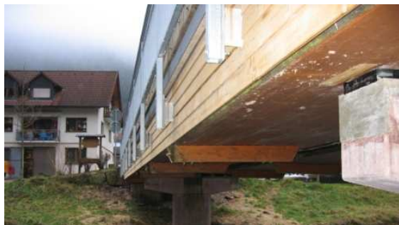
Bild 3: Ansicht auf die Unterseite. Die hinterlüftete Holzverschalung und die BSH-Träger sind gut zu erkennen.
