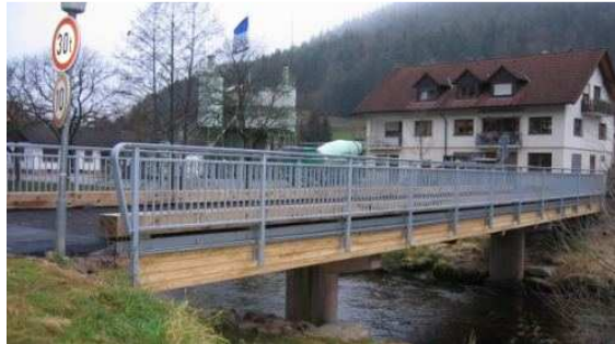
Bild 1: Die Deckbrücke ist durch eine seitliche Holzverschalung und dem geschlossenen Gussasphaltbelag optimal geschützt.
