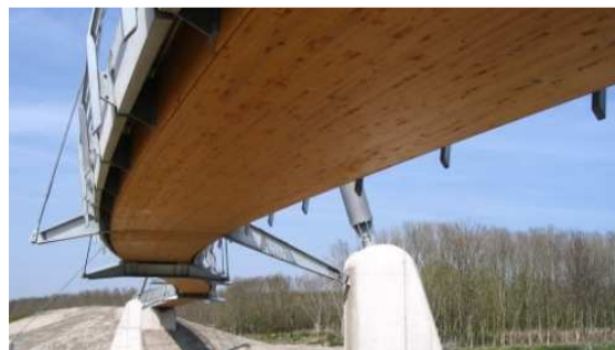
Bild 2: Ansicht auf die Unterseite der Brücke. Der große Überstand des Fahrbahnbelages aus Betonfertigteilen sorgt für einen optimalen konstruktiven Holzschutz.
