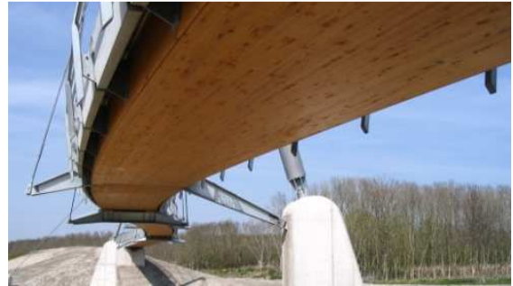
Bild 2: Ansicht auf die Unterseite der Brücke. Der große Überstand des Fahrbahnbelages aus Betonfertigteilen sorgt für einen optimalen konstruktiven Holzschutz.
