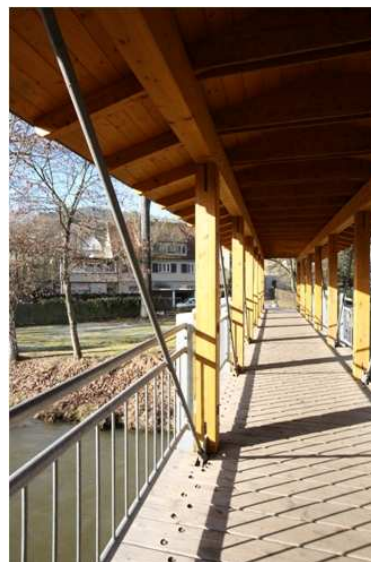
Bild 4: Die Diagonalen und die Queraussteifung unter dem Bohlenbelag, sowie das Geländer sind aus Stahl.
