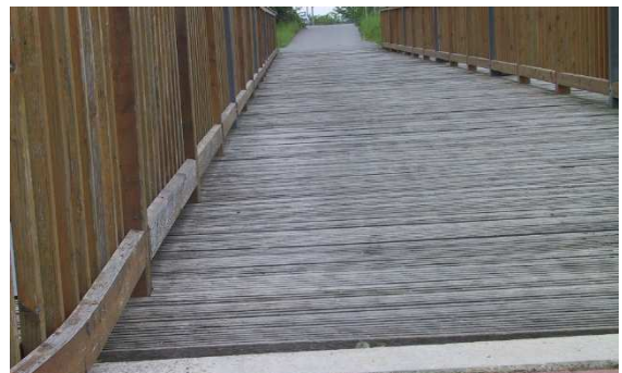
Bild 3: Bohlenbelag in einem sehr gepflegten Zustand. Weder starke Verschmutzungen, noch Vermoosung/Veralgung zu erkennen.
