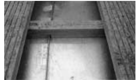
Bild 2.16 Bohlenrost auf Blechabdeckung (hier fehlt der Abstand zwischen Blech und Längsträger, im First tolerierbar)
