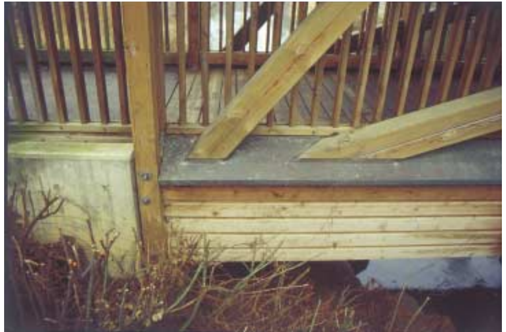
gelegentlich bewitterter Fachwerkknotenpunkt, vgl. Bild 7.7
